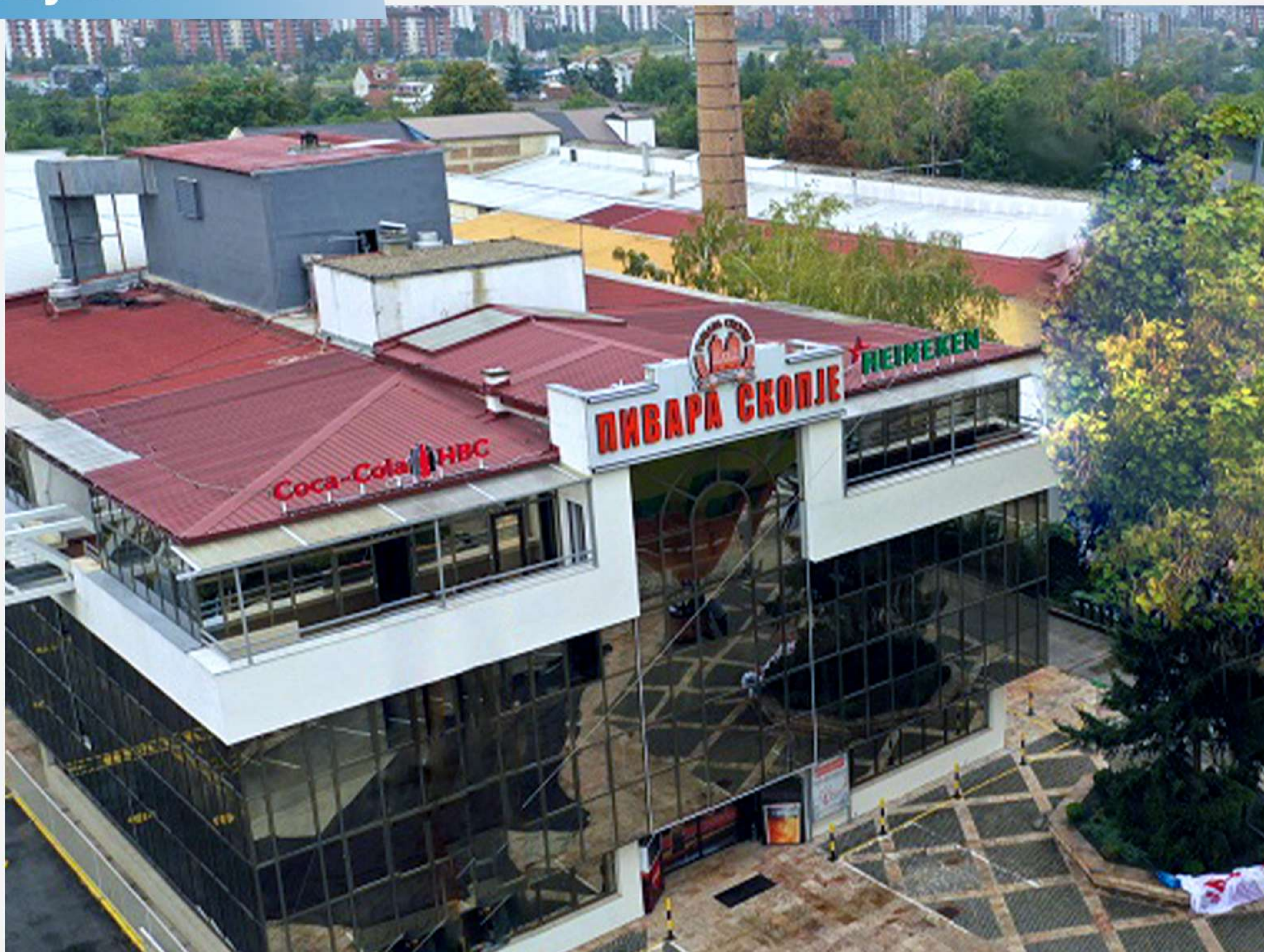
“СКОПСКА ПИВАРА”- Скопје • Chiller EWAD-C11FXS with free cooling - 1,089 kW ладилна енергија
