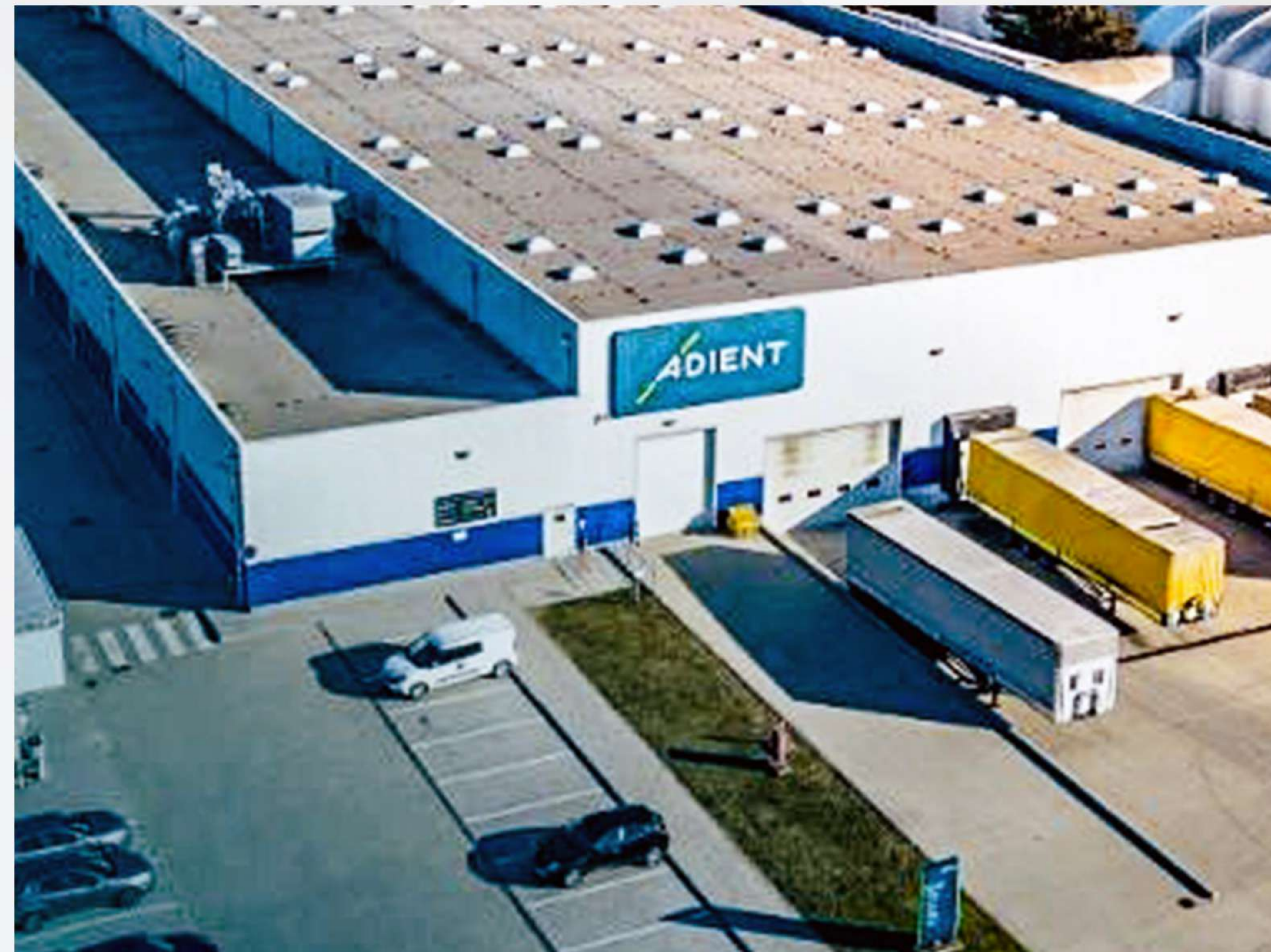
ИНДУСТРИСКИ ПОГОН “ADIENT” - Струмица • воздушно-ладилни Chiller-и
